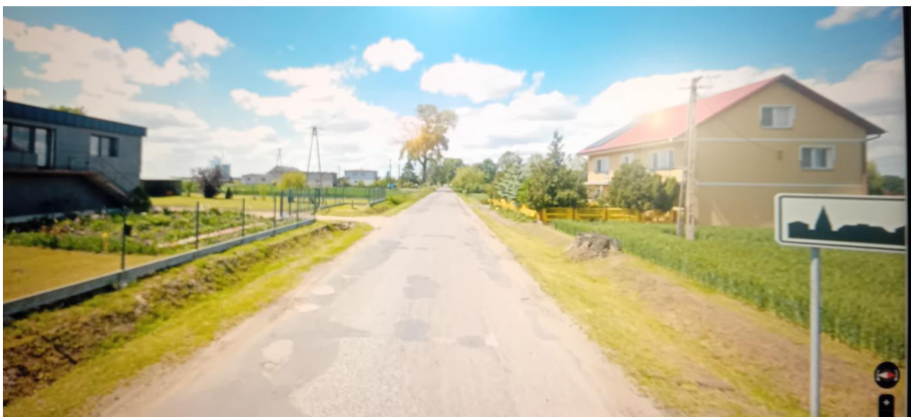
Zdjęcie nr 3. Przebieg drogi na łuku w miejscu wykonania dodatkowej warstwy wyrównawczej i ścieralnej
