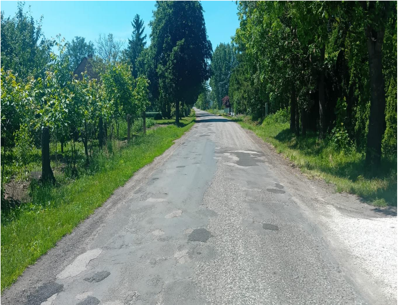
Zdjęcie nr 4 Przebieg drogi. Widoczne ubytki, spękania, wykruszenia, miejsca wykonania doraźnych remontów.
