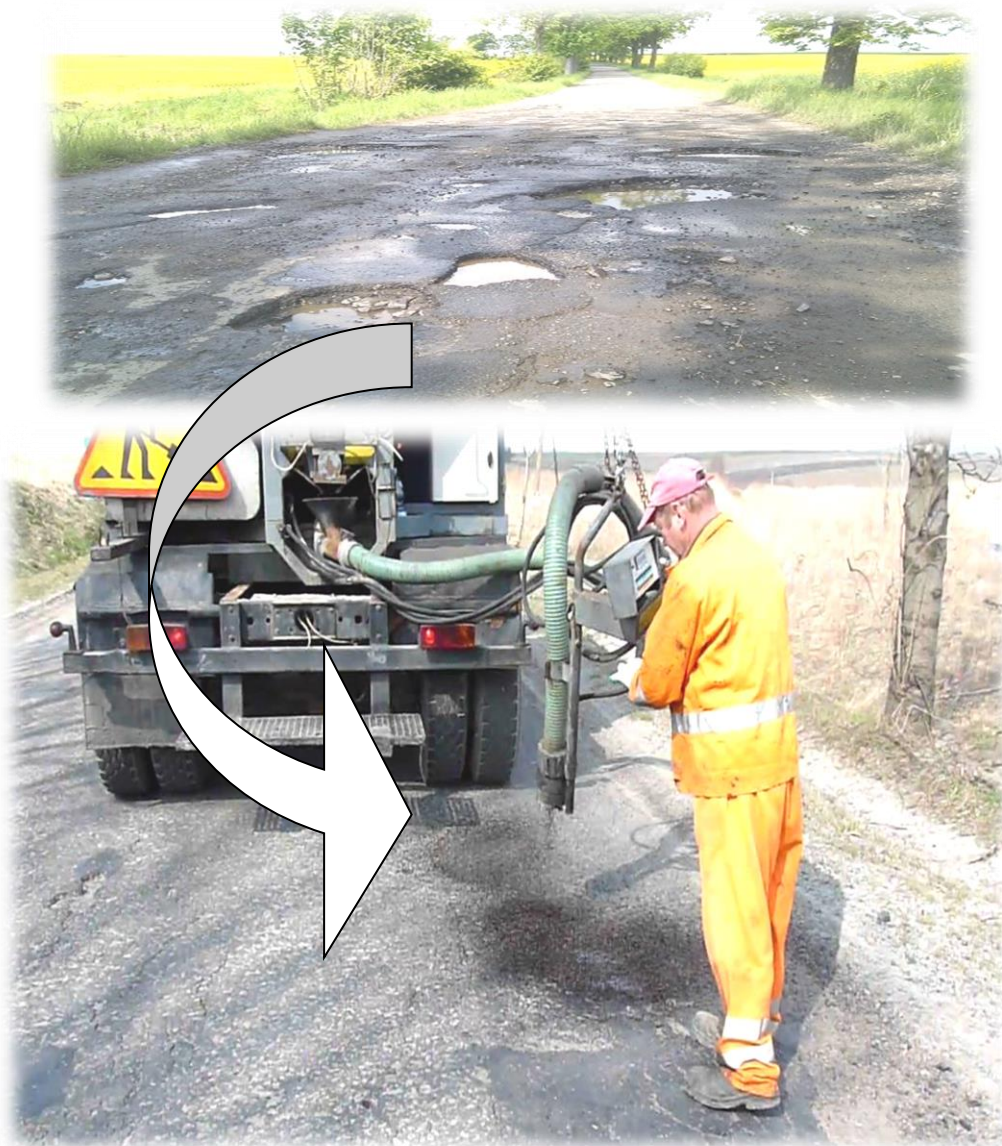
Rys. Natrysk mieszaniną gorącej emulsji asfaltowej i gysu, wykonywany przez operatora remontera drogowego (patchera).
